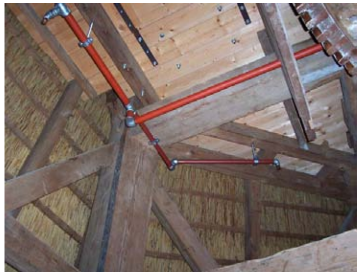
Sommige molens zijn voorzien van een sprinklerinstallatie.
